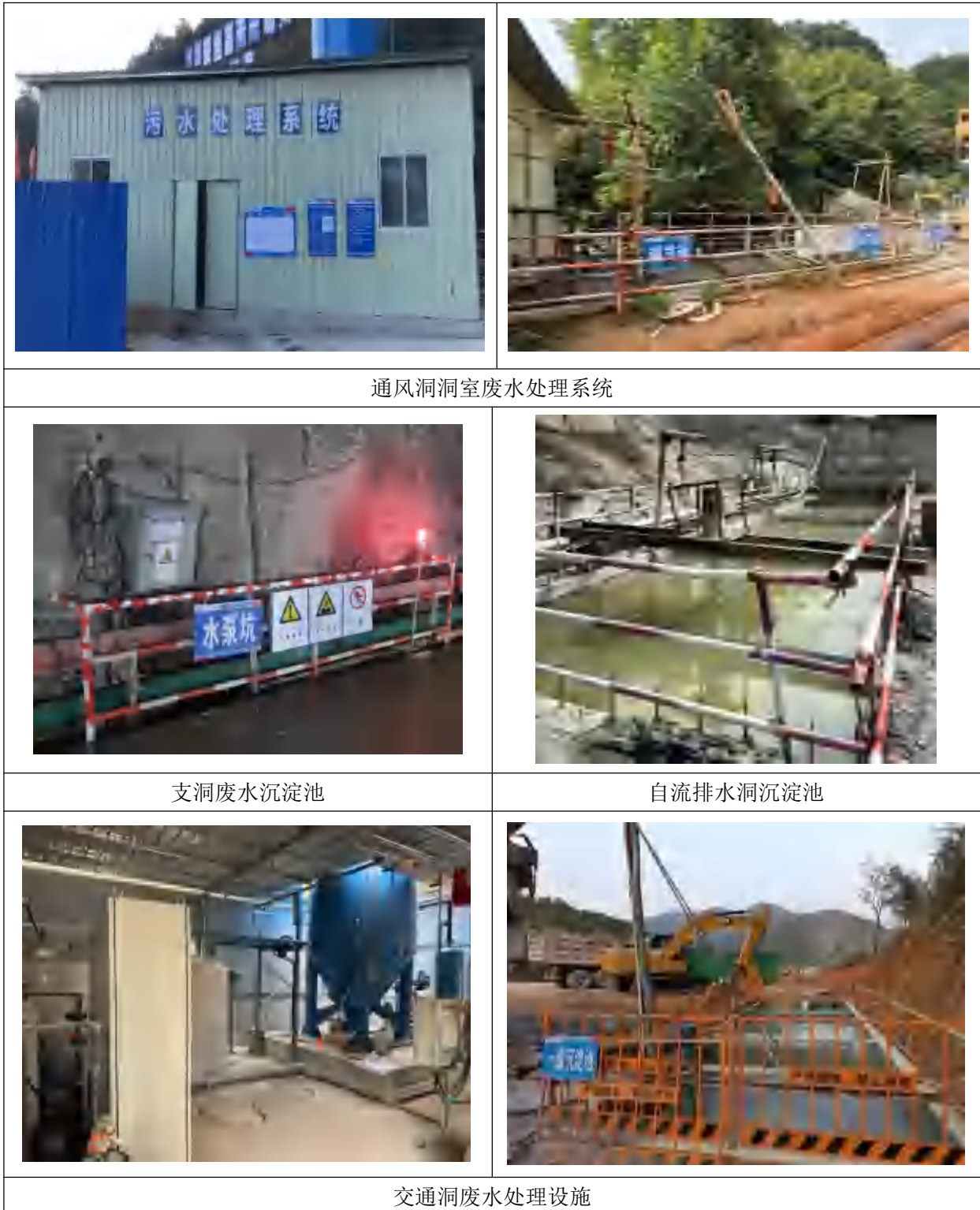
图 4.1-14 洞室废水处理设施照片
