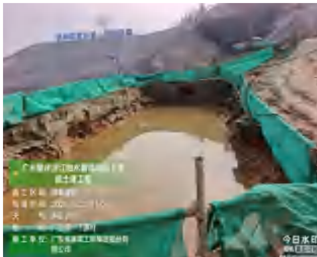
图 4.1-7 基坑废水处理
