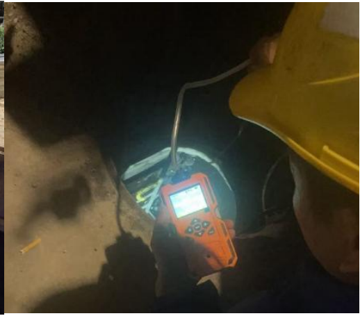
暗涵内气体含量监测
