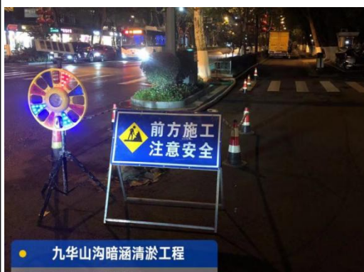
警示灯、告示牌
